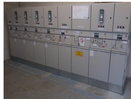
(Trafostation in der Bayerwaldstraße)
