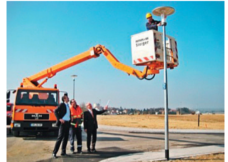
Straßenbeleuchtungsanlagen Baugebiet Humelberg
